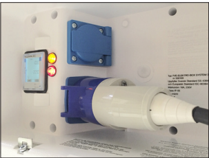
Elektriciteitsmeter in de elektriciteitskast met verlichting
