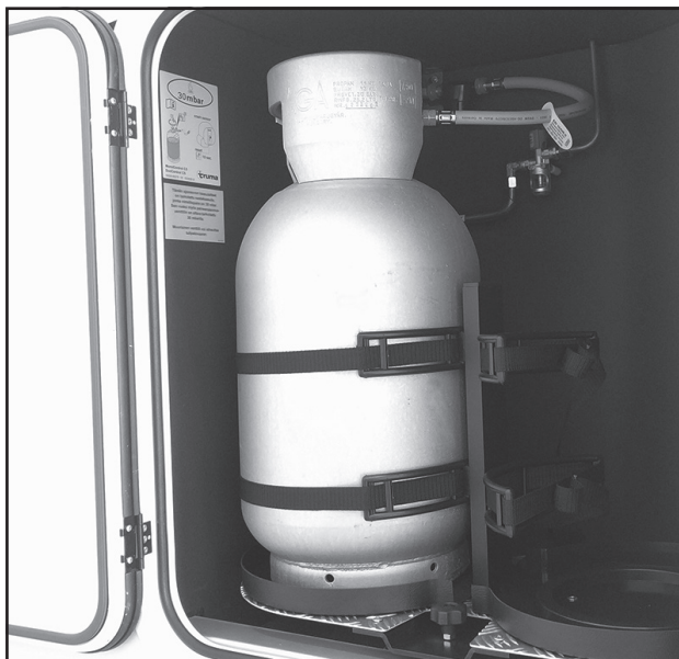
Gassflasken i gasskassen.
